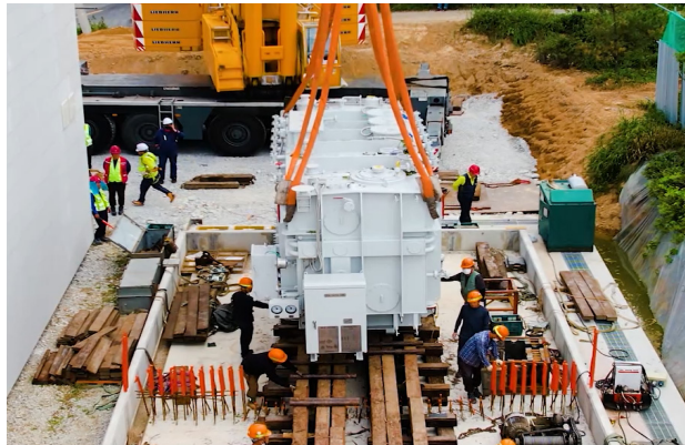
SK스페셜티 154kV 신설 변전소 설치 [SK스페셜티]
