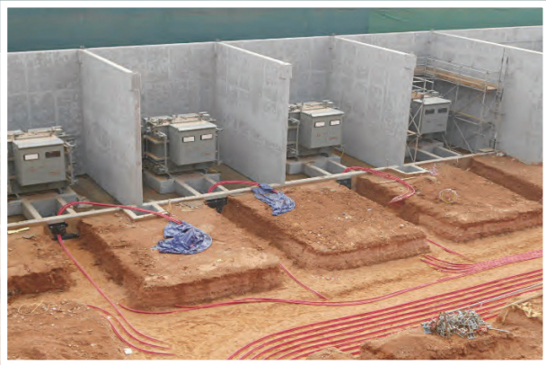
Steel & PVC Conduit
