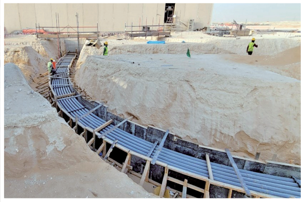
Steel & PVC Conduit
